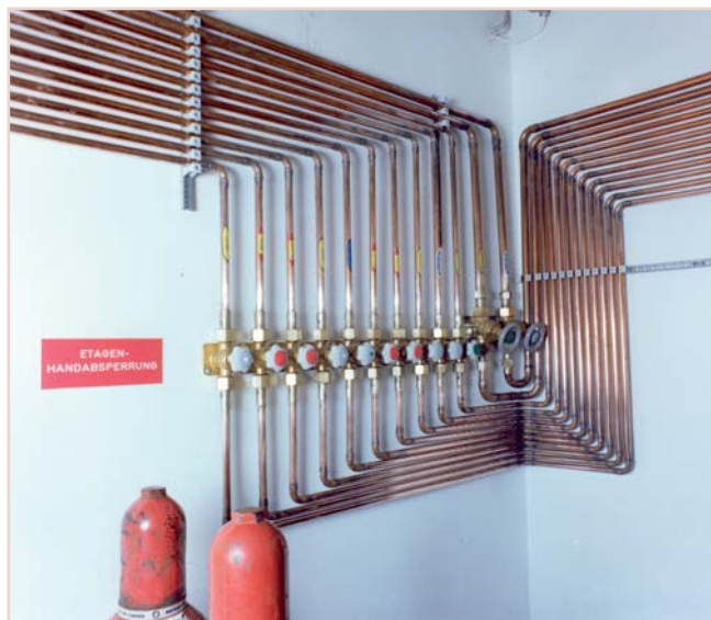
Bild 6: Medizinische Gasversorgungsanlage mit Kennzeichnung der Rohre (Bild Drägerwerke)
