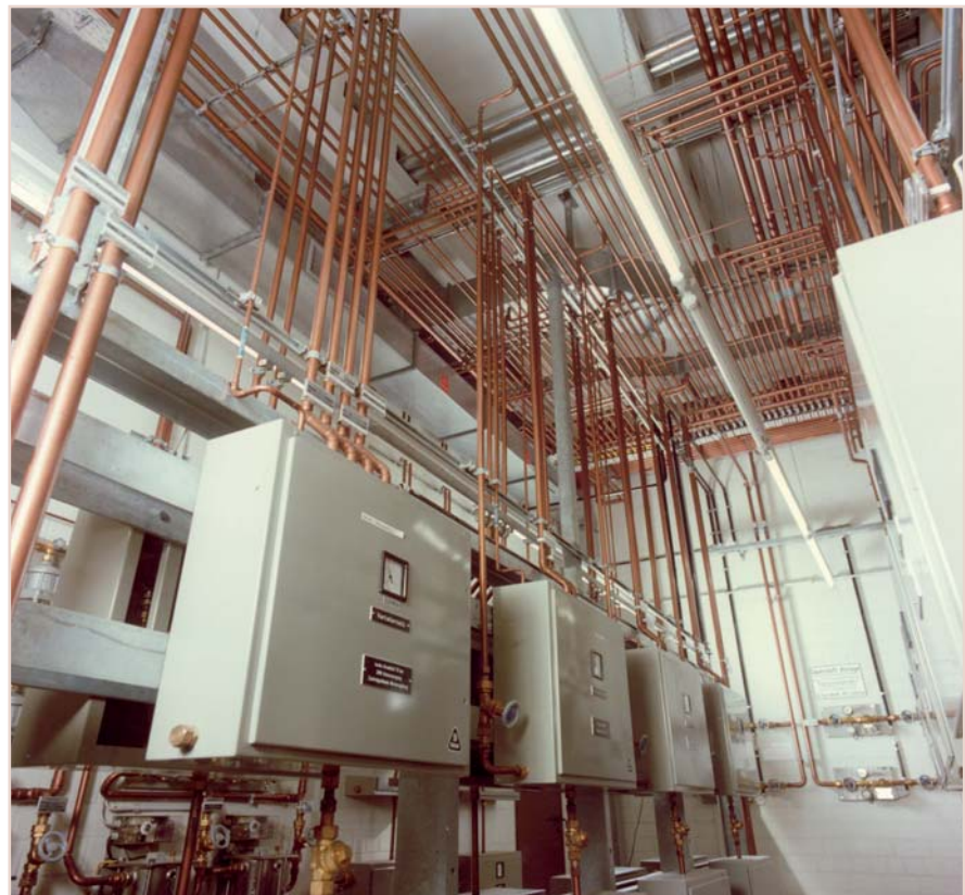
Bild 1: Anlage zur Verteilung von medizinischen Gasen (Bild Drägerwerke)
