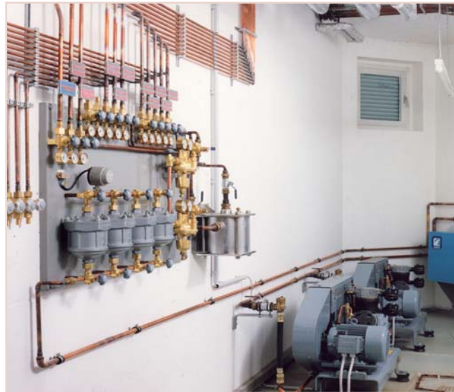
Bild 7: Anlage zur Erzeugung hochreiner Druckluft (Bild Drägerwerke)
