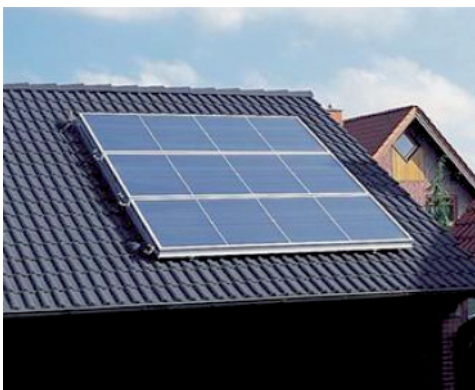
Bild 1: Solarabsorber-Flachpaneel auf Hausdach (ESTIF)
