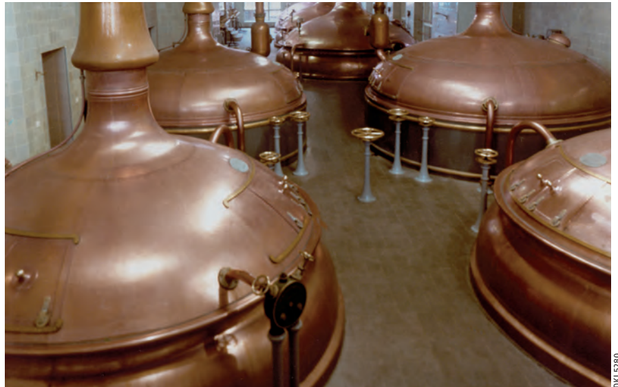
Kupferkessel in einer Brauerei
