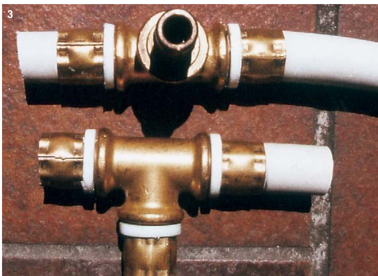
Bild 2 und 3 zeigen Messingpressverbindungen, die nach einer Spannungsrisskorrosionsbeanspruchung zerstört wurden
