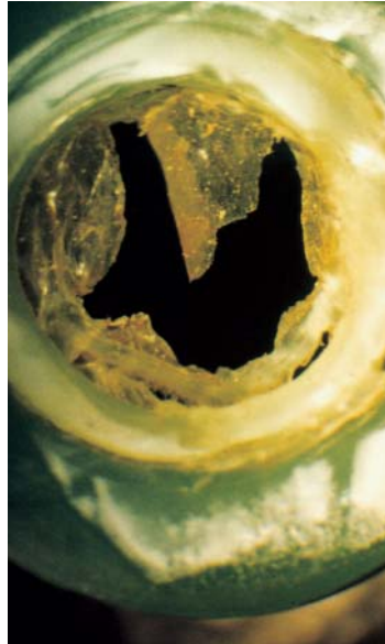
Bild 5 • Einge- engter Rohr- querschnitt (Rohrverschluss) durch zu weiten Rohreinschub beim Ver- schweißen
