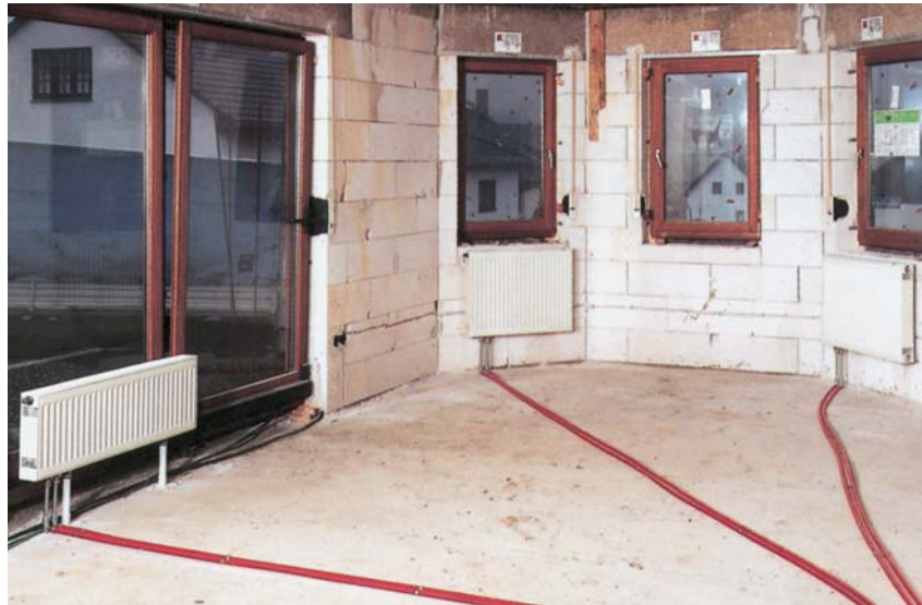
Bild 5 • Kunststoffrohrleitungsverlegung ohne Ausdehnungsbögen oder Biegeschenkel vor den Heizkörpern, wie sie in einer früheren „Praxisgerechten Technischen Information“ des Systemanbieters zu finden war. Schrumpf-, Kontraktions- und Ausdehnungskräfte beanspruchten die angrenzenden Bauteile, zum Beispiel Verschraubungen.
